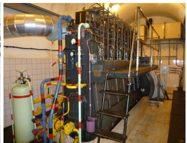
Unterirdisches Kraftwerk, Antrieb über U-Boot-Motor
